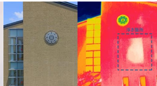
紅外線探測出浮牆
