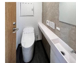
男女別トイレを完備
